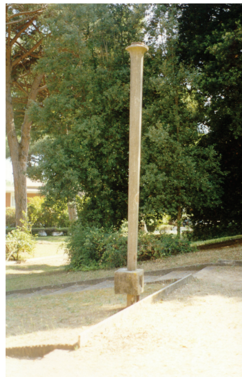
Foto 8.3 Situazioni di degrado
